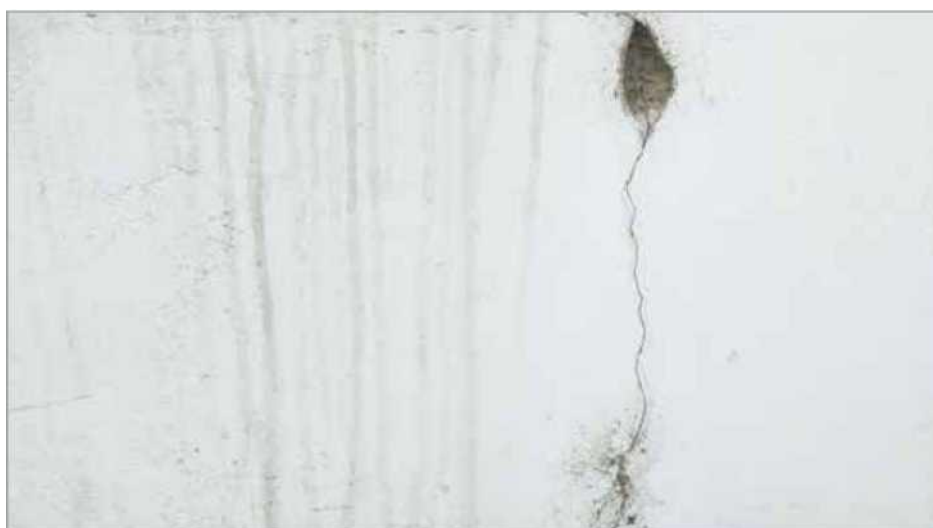
Zdjęcie nr 3 – Pęknięcia na elewacji.
