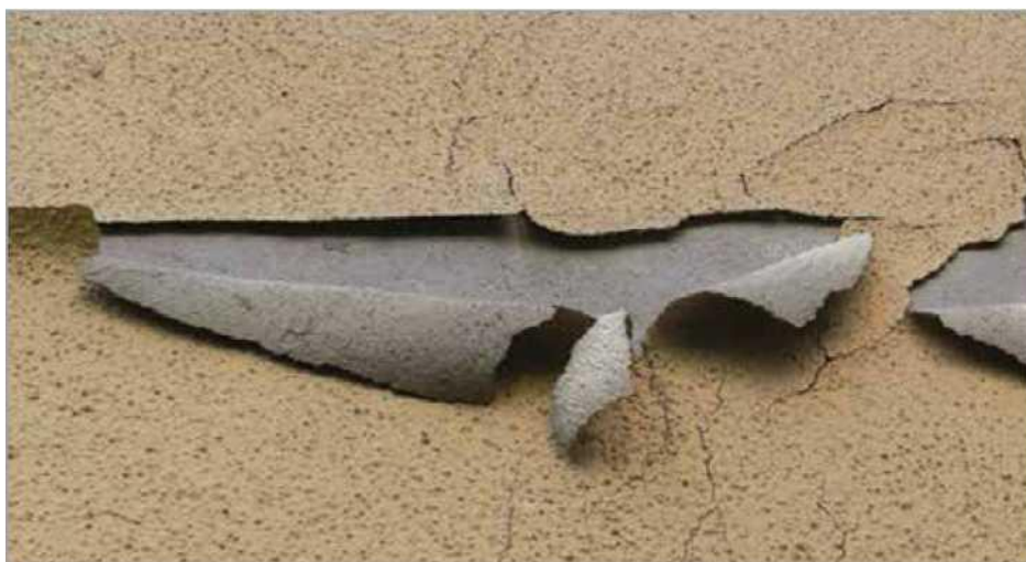
Zdjęcie nr 4 – Odspojenie tynku.
