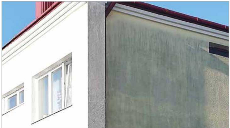
Zdjęcie nr 6 – Skażenie mikrobiologiczne elewacji.
