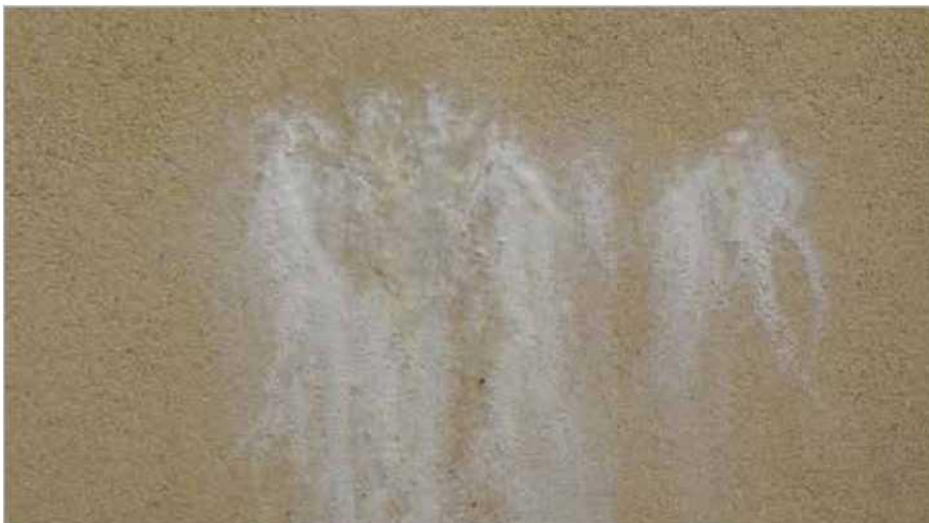
Zdjęcie nr 2 – Plamy solne na elewacji.
