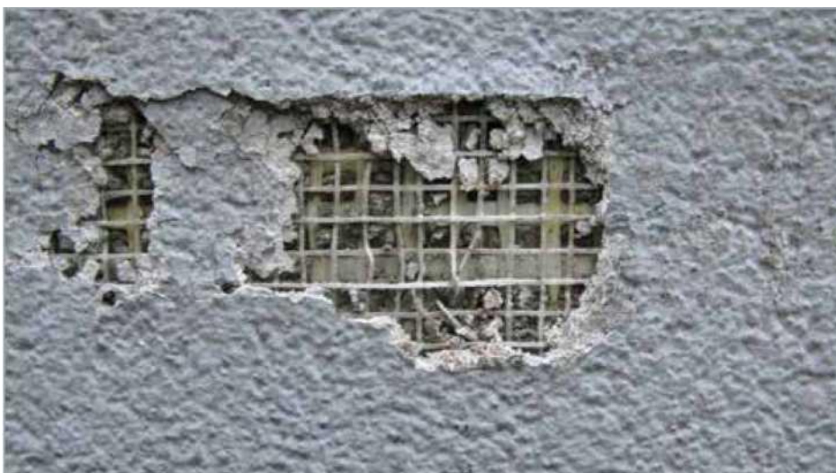
Zdjęcie nr 5 – Uszkodzona ściana
