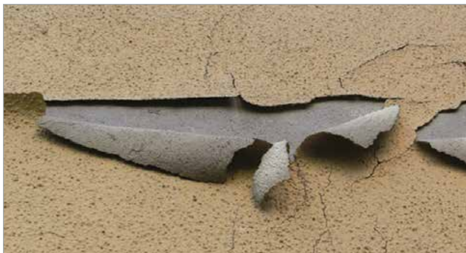
Zdjęcie nr 4 - Odspojenie tynku.
