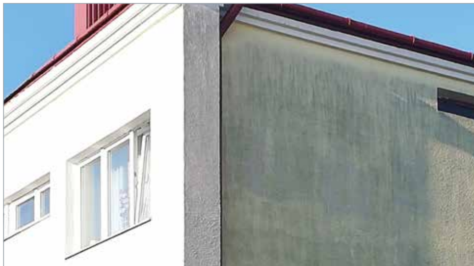
Zdjęcie nr 6 - Skażenie mikrobiologiczne elewacji.
