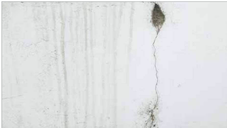
Zdjęcie nr 3 - Pęknięcia na elewacji.
