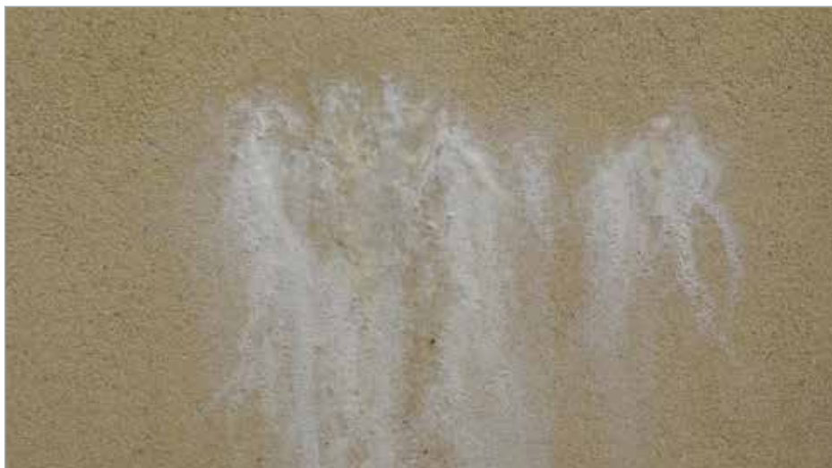
Zdjęcie nr 2 - Plamy solne na elewacji.
