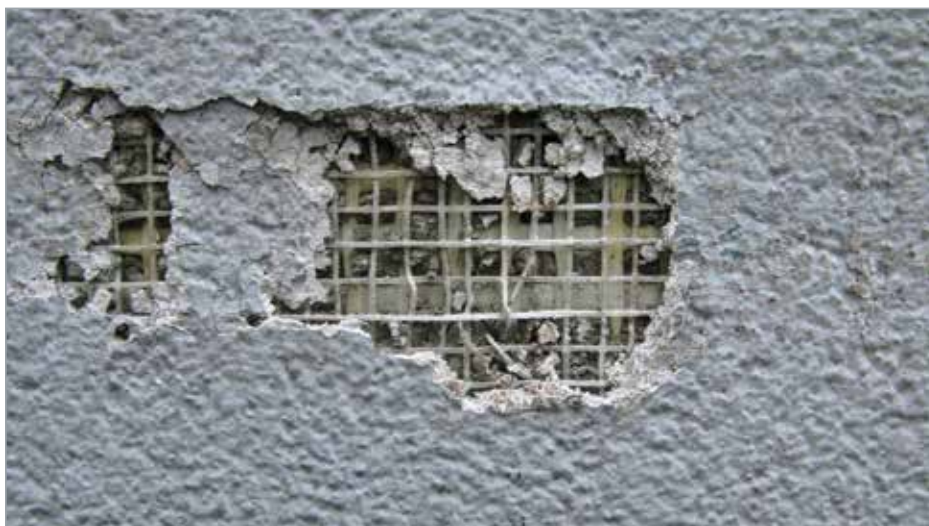
Zdjęcie nr 5 - Uszkodzona ściana
